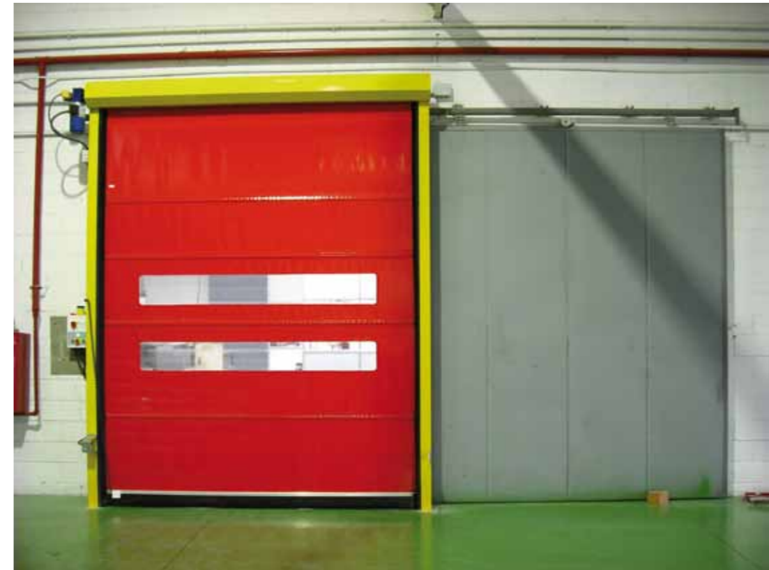
Conjunto puerta cortafuegos con rápida.
